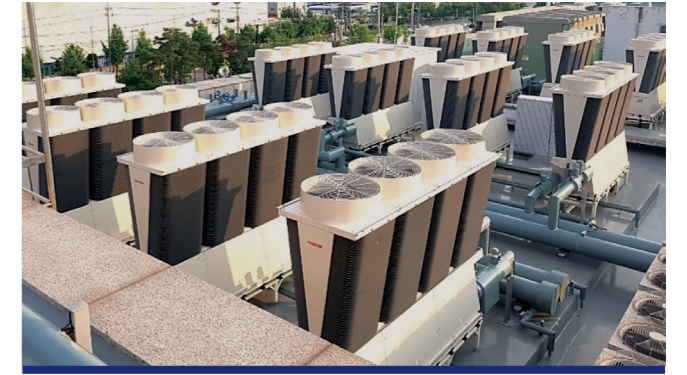
CJ 대한통운 물류허브 터미널 | 대전시 USX Edge 히트펌프 냉동기
