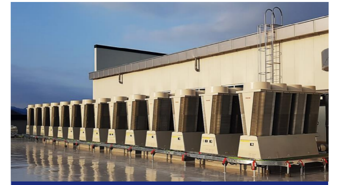
알에프바이오 공장 | 강원도 원주시 USX Edge 히트펌프 냉동기
