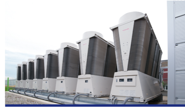
스마트팜 | 전라북도 김제시 USX Edge 히트펌프 냉동기 (한국농어촌공사 농업 에너지 이용 효율화 사업)
